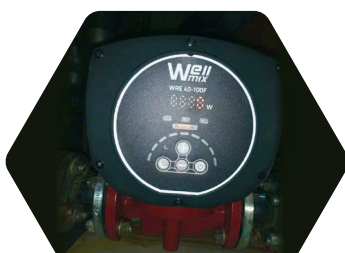
ИТП, г. Екатеринбург, ул. Курчатова, 27, к.2
