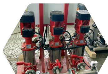
ЖК, установки ВНС и ПНС г. Владикавказ
