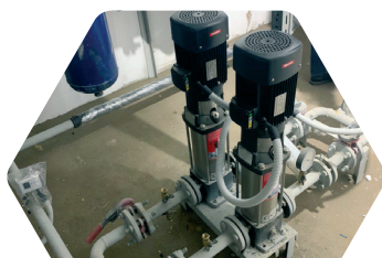
Индивидуальный тепловой пункт г. Уфа,
